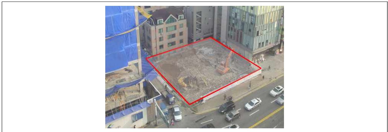
[그림] 대지 내에서 절성토량이 발생하지 않는 사례 - 기존 건축물을 철거하는 재사용 대지 (2021.11.01.)
