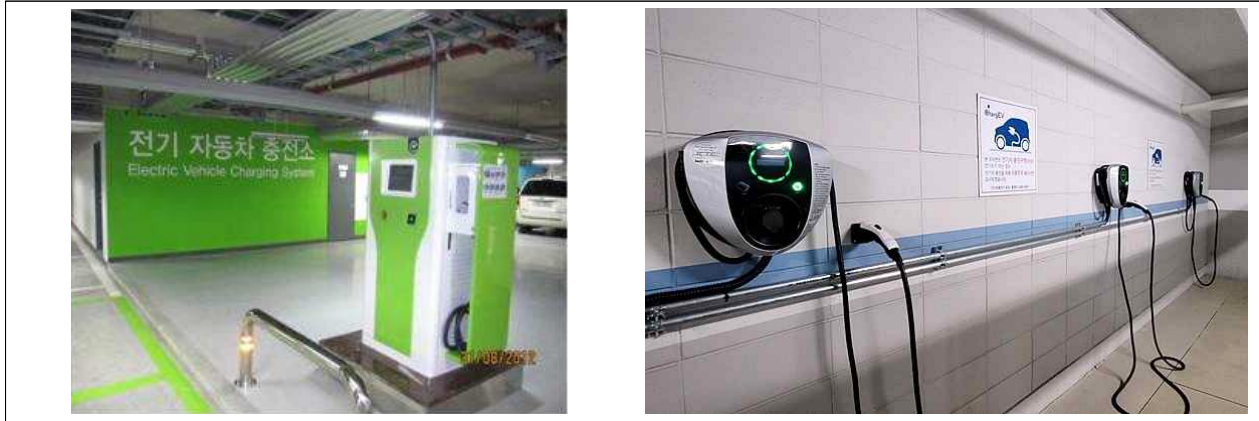
[그림] 전기자동차 주차장 및 충전시설 사례
